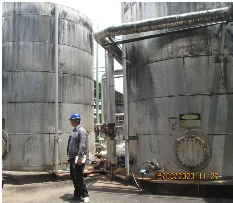
รูปที่ 4-1 หม้อต้มน้ำร้อนของโรงงาน
