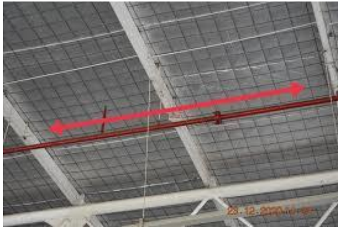
รูปที่ 4-3 อุปกรณ์ตรวจจับความร้อนชนิดเส้น
