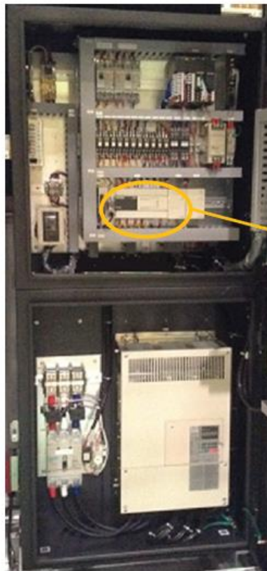
แผงควบคุม
