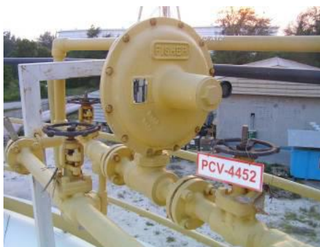
รูปที่ 3-3 วาล์วควบคุมก๊าซไนโตรเจนติดตั้งบนถังเก็บ
