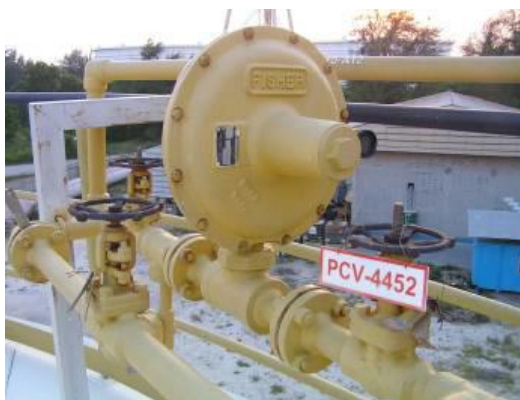
รูปที่ 3-4 วาล์วควบคุมก๊าซไนโตรเจนติดตั้งบนถังเก็บ
