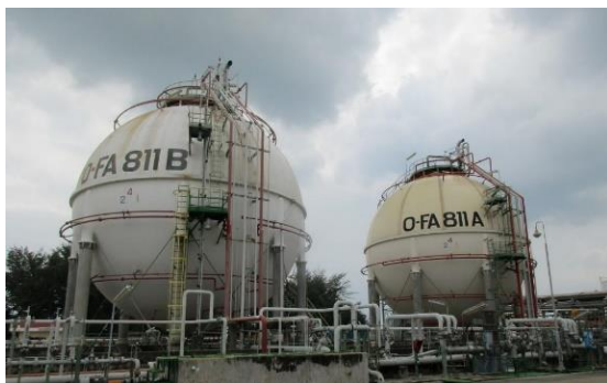
รูปที่ 3-6 ระบบพ่นน้ำ (Water Spray) เป็นรูปวงแหวนล้อมรอบถังเก็บ
