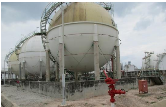
รูปที่ 3-5 Fire Monitor รอบถังเก็บ
