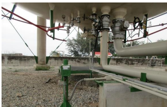
รูปที่ 3-7 เครื่องตรวจจับก๊าซ (Gas Detector) บริเวณถังเก็บ
