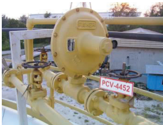
รูปที่ 3-5 วาล์วควบคุมก๊าซไนโตรเจนติดตั้งบนถังเก็บ
