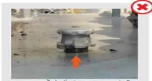
รอยคราบน้ำมันรั่วซึมตามบริเวณปะเก็น
