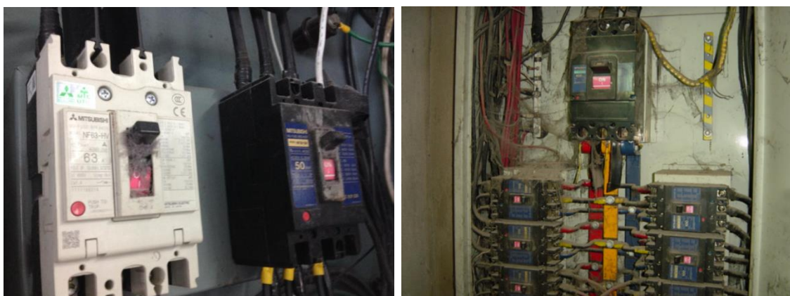
รูปที่ 4.13 การตรวจสอบสภาพภายในตู้สวิตช์ พบหยากใย และเส้นใยที่อาจติดไฟได้ (ไม่ถูกต้อง)
