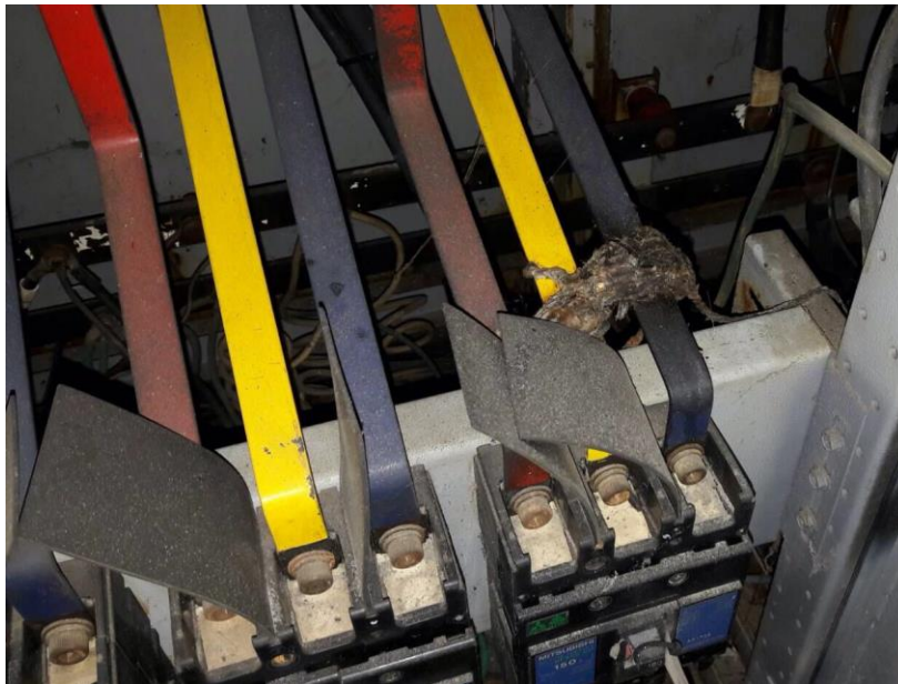
รูปที่ 4.14 การตรวจสอบความผิดปกติทางกายภาพภายในตู้สวิตช์ พบซากหนูลัดวงจรที่บัสบาร์ (ไม่ถูกต้อง)
