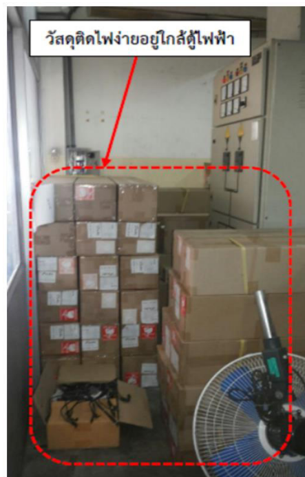
รูปที่ 4.12 การจัดเก็บวัสดุที่ติดไฟได้ไว้ใกล้กับตู้สวิตช์ (ไม่ถูกต้อง)
