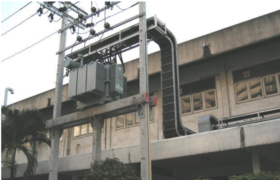
รูปที่ 4.7 ตัวอย่างการตรวจสอบหม้อแปลงไฟฟ้าที่วางบนนั่งร้านหม้อแปลง
