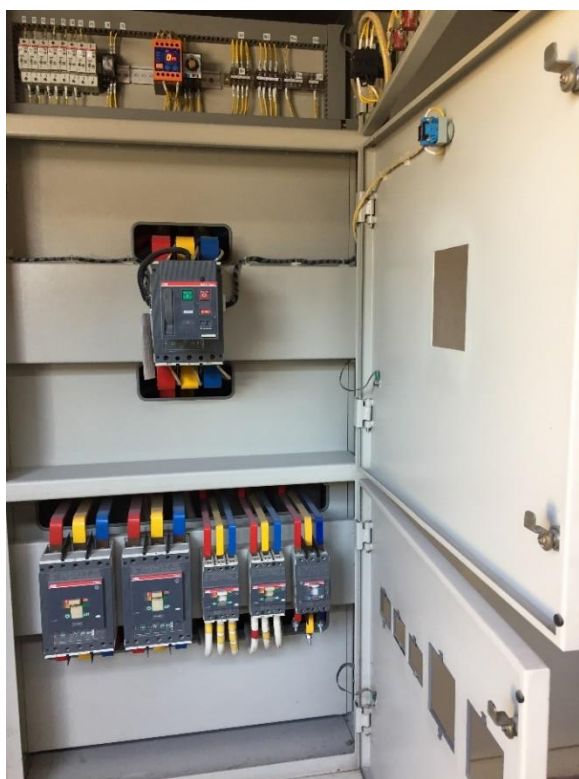
รูปที่ 4.16 ตัวอย่างการตรวจสอบการต่อฝากของฝาตู้เมนสวิตช์
