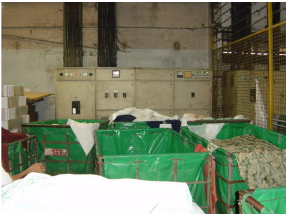
รูปที่ 4.11 การวางสิ่งของกีดขวางพื้นที่ว่างเพื่อปฏิบัติงานของตู้สวิตช์ (ไม่ถูกต้อง)
