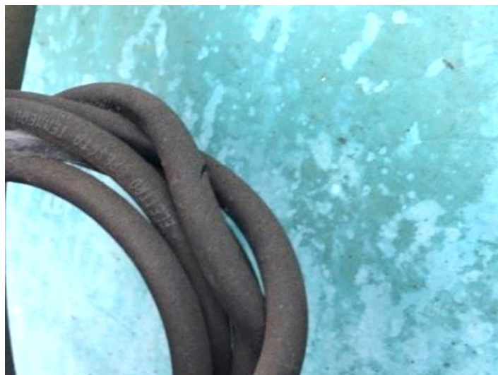
รูปที่ 4.1 ตัวอย่างสายไฟฟ้าที่ฉนวนชำรุด เสื่อมสภาพ
