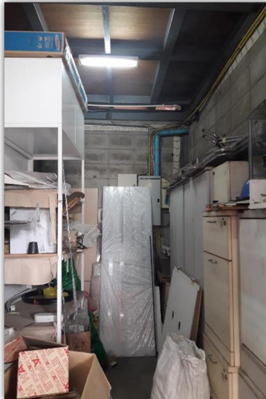
รูปที่ 4.19 การวางสิ่งของกีดขวางพื้นที่ว่างเพื่อปฏิบัติงานของแผงย่อย (ไม่ถูกต้อง)
