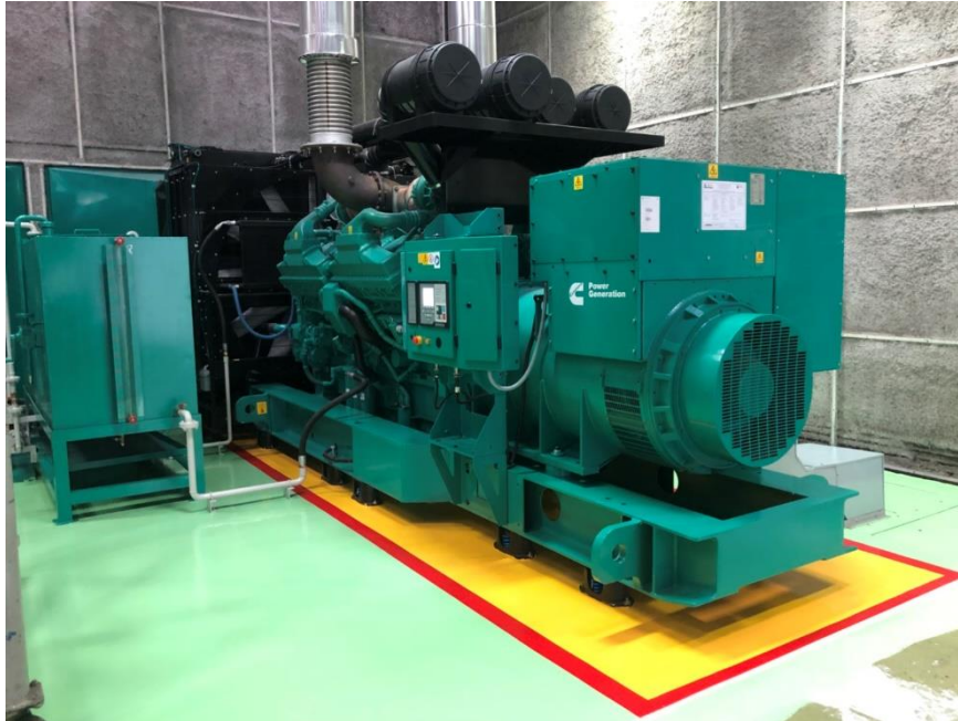
รูปที่ 1.48 เครื่องกำเนิดไฟฟ้า
