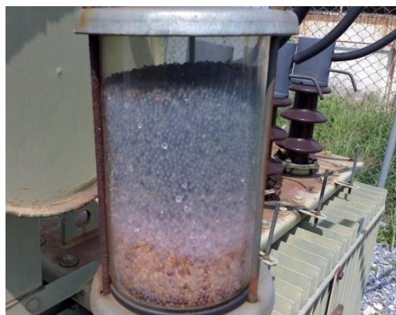
รูปที่ 4.6 ตัวอย่างการตรวจสอบสภาพสารดูดความชื้นของหม้อแปลง
