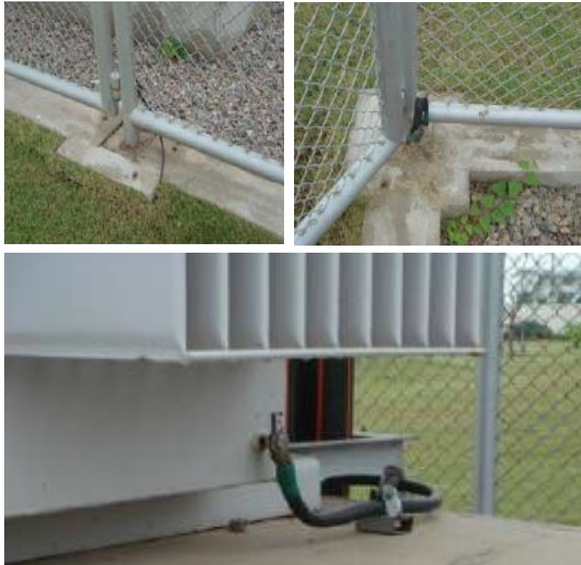
รูปที่ 4.5 ตัวอย่างการตรวจสอบการต่อลงดินของหม้อแปลง
