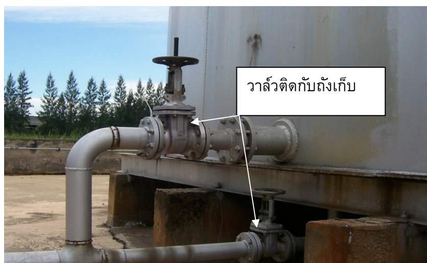
รูปที่ 4-4 วาล์วที่ติดตั้งกับถังเก็บกรดซัลฟิวริก
