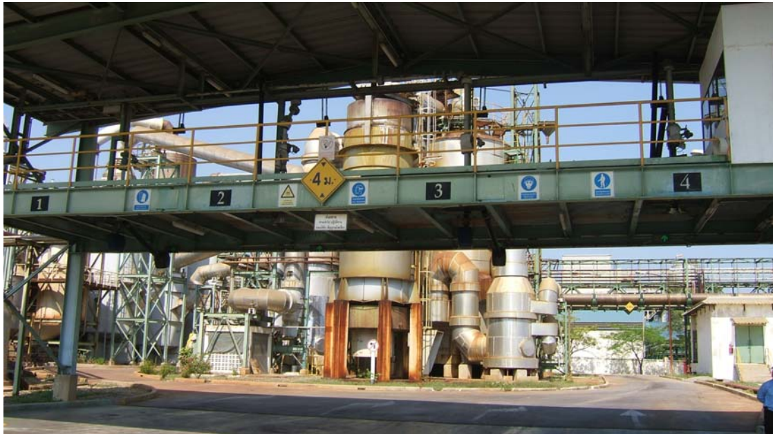
รูปที่ 5-10 สถานีขนถ่ายกรดซัลฟิวริกจากถังเก็บลงสู่แท้งก์ติดตเรียง
