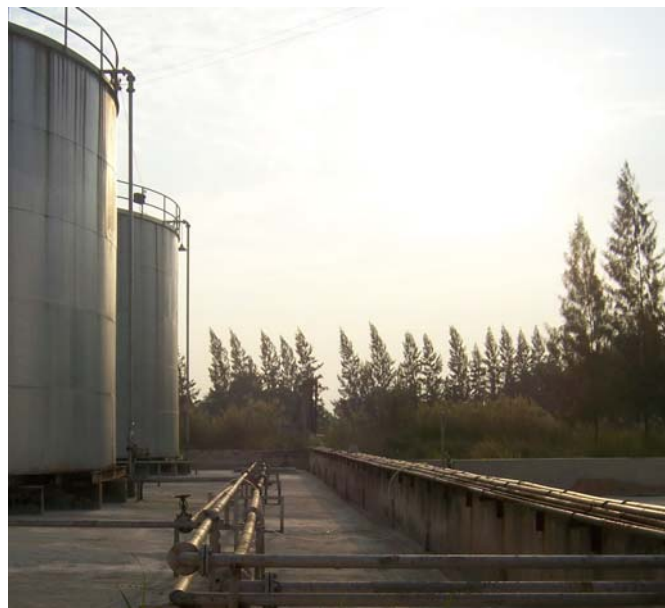
รูปที่ 5-1 การขนถ่ายกรดซัลฟิวริกความเข้มข้น 98.5% โดยน้ำหนัก ทางท่อเหล็กหล่อเข้าถึงเก็บที่อุณหภูมิ 45-50 °C
