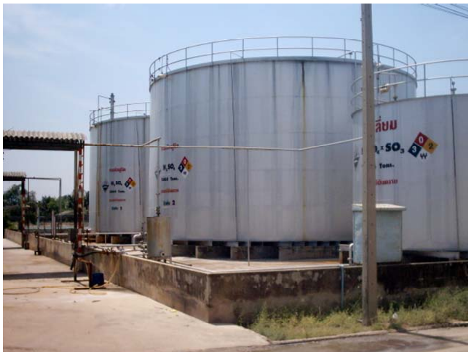
รูปที่ 4-1 ถังเก็บ แท็งก์ฟาร์ม และพื้นที่กักเก็บกรดซัลฟิวริก
