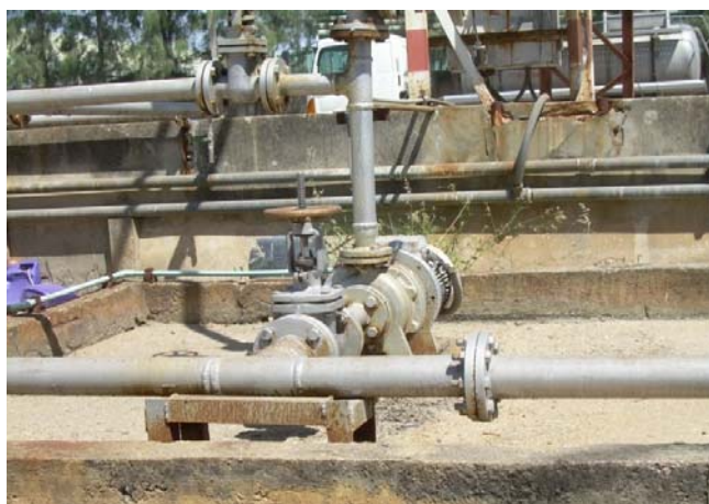
รูปที่ 4-3 ตัวอย่างเครื่องสูบลดตั้งภายในเขื่อนกั้นที่ใช้ขนถ่ายกรดซัลฟิวริกจากถังเก็บไปยังแท็งก์ติดตั้ง
