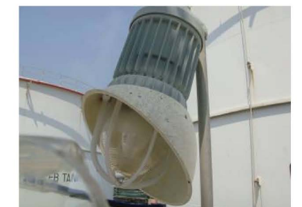
รูปที่ 5-5 โคมไฟส่องสว่างชนิดทนการระเบิดที่ติดตั้งข้างถัง
