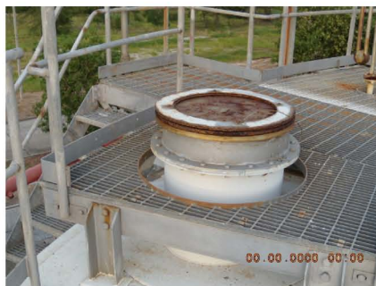
รูปที่ 5-2 ระบบระบายอากาศฉุกเฉิน
