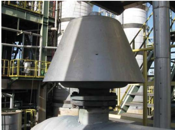
รูปที่ 5-3 วาล์วควบคุมความดันภายใน
