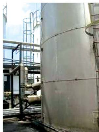
รูปที่ 5-2 การหุ้มฉนวนที่ถังเก็บ
