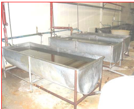
รูปที่ 3-2 ถังต้มที่ใช้ไอน้ำในการให้ความร้อน
