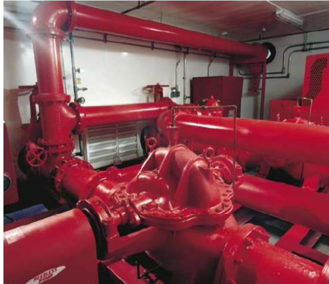
รูปที่ 4.1.2 แสดงการติดตั้งเครื่องสูบน้ำดับเพลิงแบบนอน
