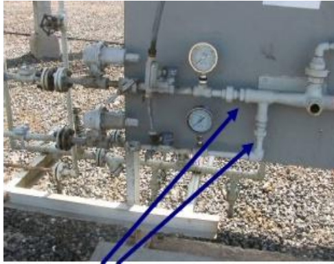
รูปที่ 4-9 ตัวอย่าง Ignition Air และ Gas Orifice
